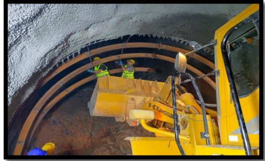
صورة رقم (٢٤) معالجة انهيارات النفق الثاني
